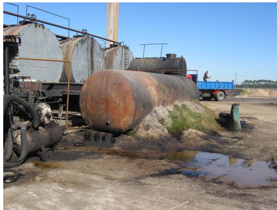
Vista de tanques de abastecimiento a la planta asfáltica
