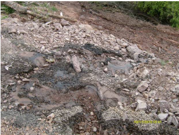
Ilustración 13 – Infiltración y escurrimiento superficial de efluentes del sedimentador de planta asfáltica
