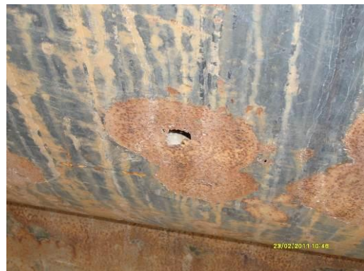
Ilustración 9: Depósito de fueloil con capa exterior oxidada y perforada
