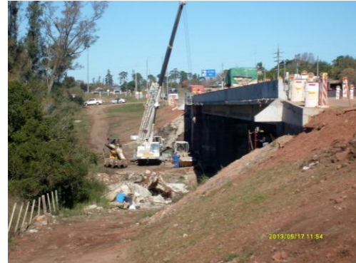
Ilustración 4: Escombros sobre orilla del A° Corrales, progresiva 257K600 a (+) y máquinas trabajando.
