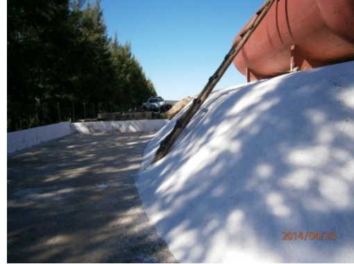
Ilustración 11-Acondionamiento de tanque de gasoil con sistema de contención
