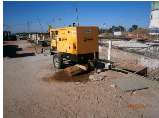
Ilustración 12 - Generador y derrame de gasoil, en obrador de SACEEM Cno. Tomkinson
