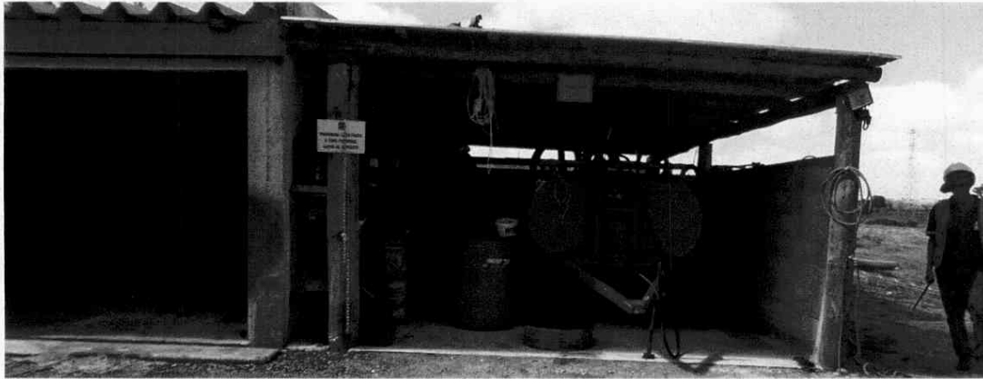
Gráfico 3-1 Acopio de combustibles en el obrador
