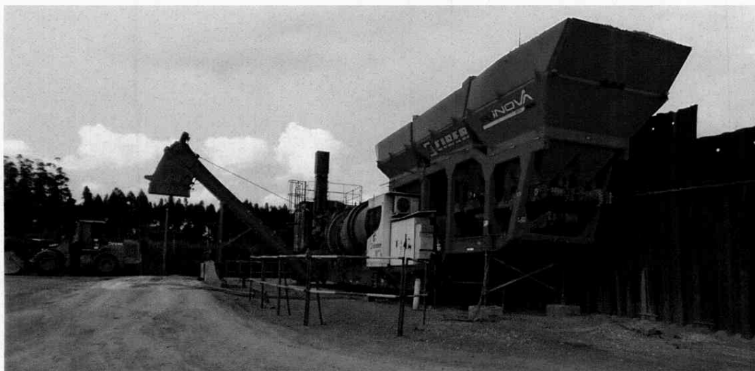
Figura 4-2 Planta de asfalto
