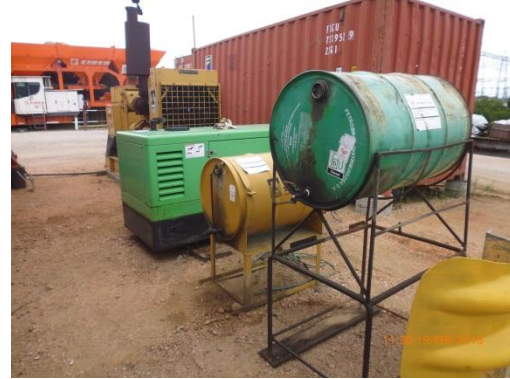
Ilustración 18 – Tanques en uso para la planta asfáltica. Colocar bandejas de contención. A la salida se observan manchas de vertido directo al terreno.
