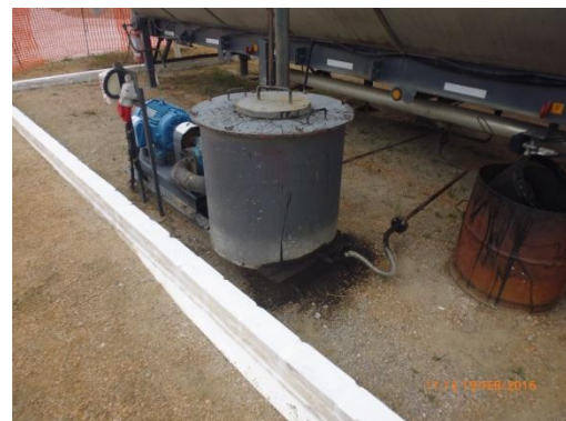
Ilustración 16 – Vista de la planta asfáltica. No se impermeabilizó el piso.
