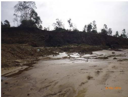
Ilustración 12 – Zona de préstamos P07. Taludes no estables.
