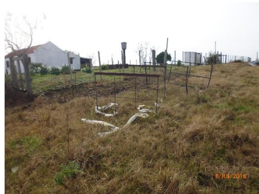
Ilustración 7 – Obrador. Restos de materiales de obra.
