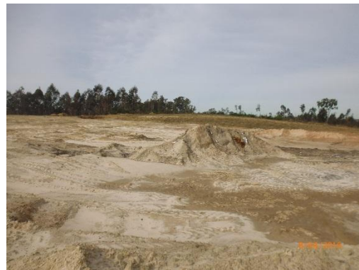
Ilustración 13 – Zona de préstamos P07. No se niveló la zona explotada.
