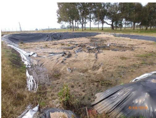
Ilustración 8 – Obrador. No se retiró la membrana ni se acondicionó la zona de acopio.
