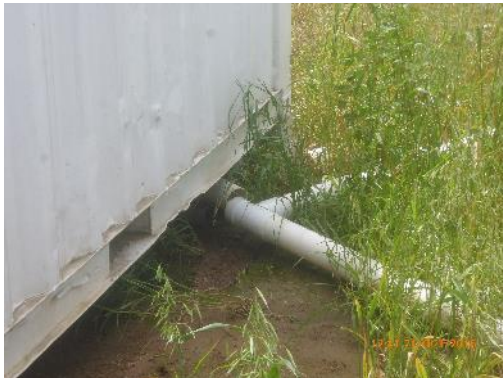
Ilustración 18 - Nuevo campamento: colector de baños desconectado
