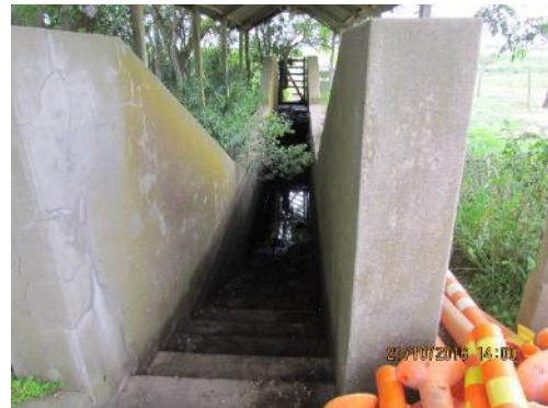
Ilustración 7 - Derrames y pluviales contaminadas hacia el interior del pozo del antiguo lavado de ovejas.
