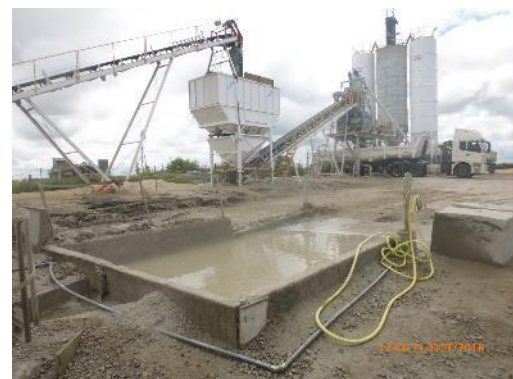
Ilustración 21 - Nuevo campamento: sedimentador para lavado de camiones y reciclaje de agua clarificada
