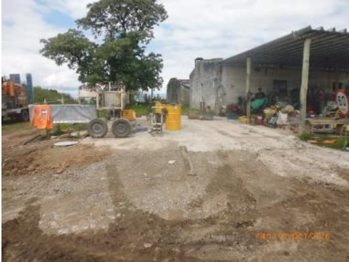
Ilustración 4 - Zona de lavado de maquinaria y depósito fijo impermeable a la izquierda.
