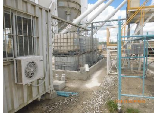
Ilustración 23 – Nuevo campamento: productos químicos acopiados dentro de pileta de contención
