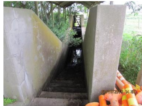
Ilustración 7 - Derrames y pluviales contaminadas hacia el interior del pozo del antiguo lavado de ovejas.
