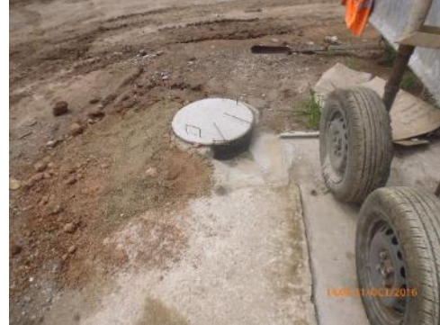
Ilustración 5 - Depósito fijo impermeable con rejilla.
