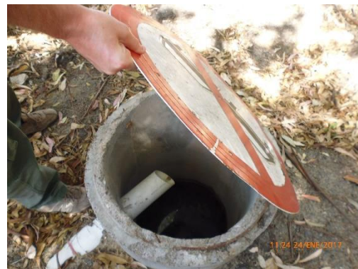
Ilustración 12 - P07. Obrador. Drenaje pluvial de caseta de contención
