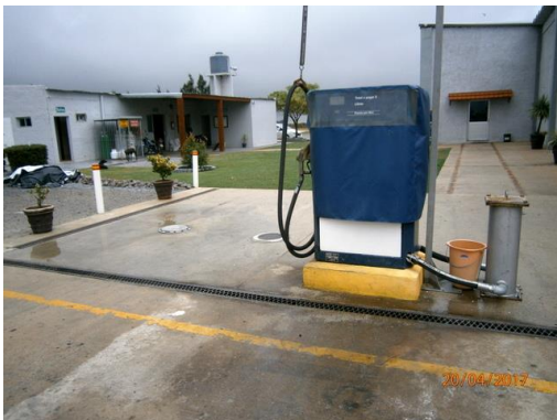
Ilustración 12 – Tanques de combustible bajo tierra y surtidor
