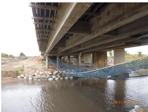
Ilustración 21 - Red de seguridad por caída de materiales de construcción.
