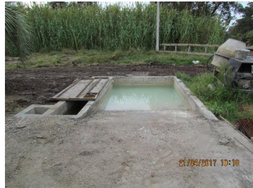
Ilustración 22 - Pileta para lavado de planta de hormigón
