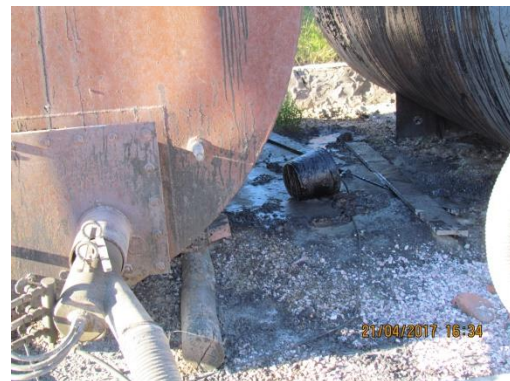
Ilustración 15 – Vertidos de asfalto sin impermeabilización en obrador de Techint
