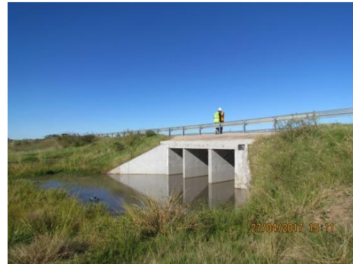
Ilustración 5 – Alcantarilla H de 3 bocas (-)
