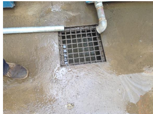
Ilustración 6 – Trampa en depósito de combustible
