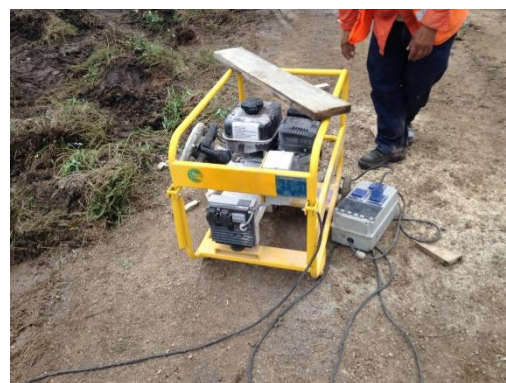
Ilustración 22 – Generador sin bandeja de contención
