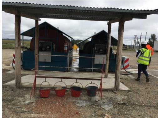
Ilustración 17 – Zona de depósito de combustibles
