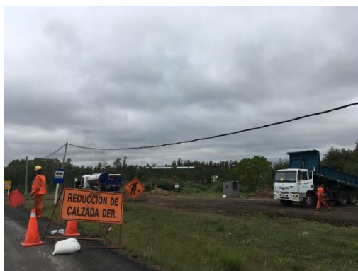
Ilustración 21 – Señalización en ruta N° 74
