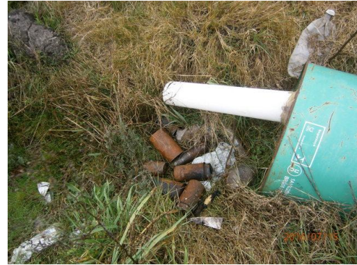
Ilustración 5-Filtros en desuso a la salida del sistema de filtración sanitario, 58K800
