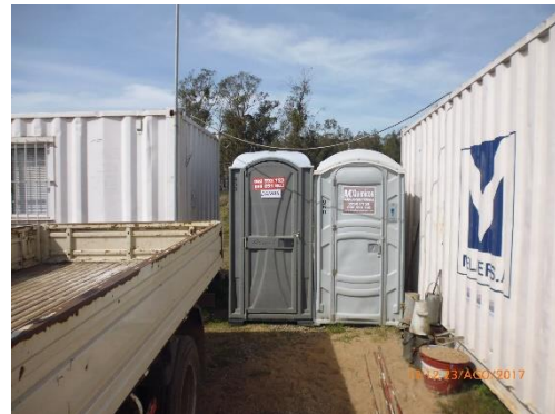
Ilustración 8 - Obrador. Baños químico.
