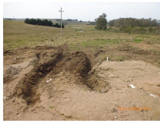
Ilustración 11 - Obrador. Depósitos fijos enterrados. Izquierda: caño sin conectar.
