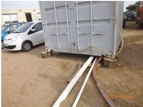
Ilustración 12 - Obrador. Baño fijo en contenedor.
