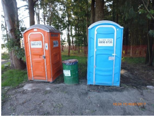
Ilustración 5 - P07. Obrador. Baños químicos.
