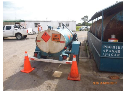
Ilustración 6 - Obrador. Tanques móvil y fijo, surtidores de gasoil.
