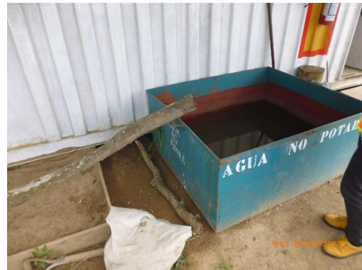
Ilustración 18 - Obrador. Tanque de agua con cal para probetas de ensayos.
