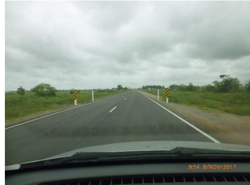
Ilustración 22 - Tramo del contrato.
