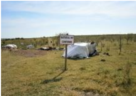
Ilustración 6 - Obrero. Zona de acopio de materiales no conformes
