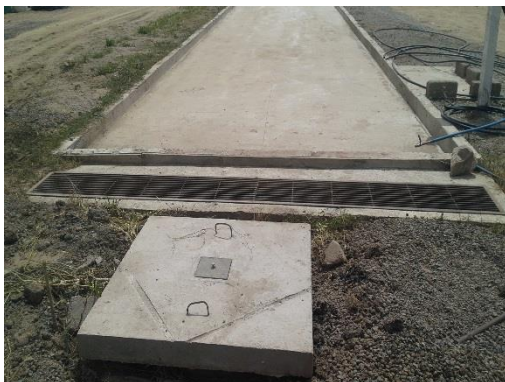
Ilustración 13 - Obrador. Unidad para lavado de maquinaria. Reja y depósito fijo.
