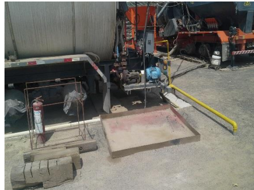
Ilustración 22 - Planta asfáltica. Bandejas para trasvase.
