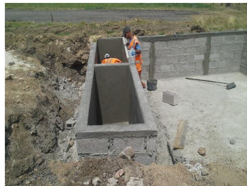
Ilustración 14 - Obrador. Pileta y sedimentadores para el lavado de mixers de hormigón.
