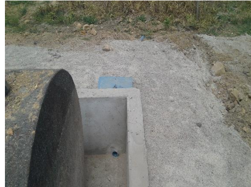
Ilustración 10 - Obrador. Caño y cámara con llave de paso para drenar pluviales.
