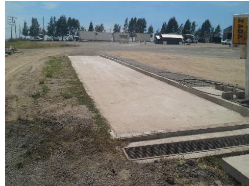
Ilustración 12 - Obrador. Unidad para lavado de maquinaria.
