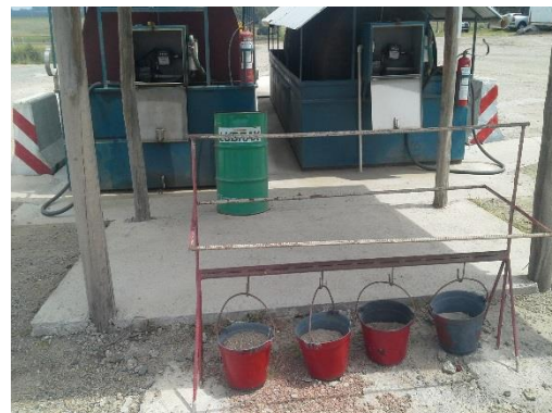
Ilustración 6 - Obrador. Depósitos de combustible.
