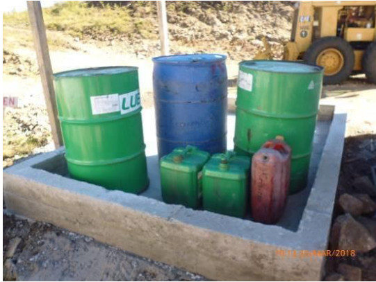
Ilustración 10 - Obrador: Depósito de hidrocarburos
