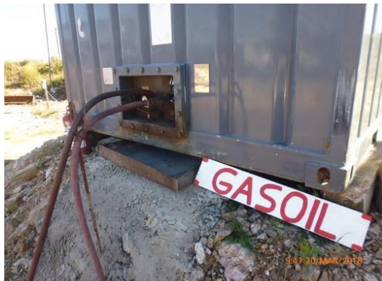
Ilustración 19 - Obrador: Detalle de tanque de gasoil
