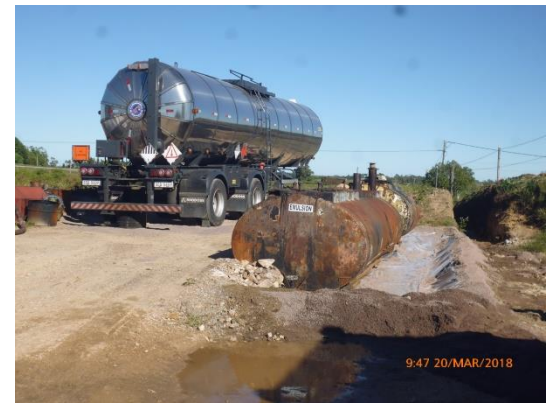
Ilustración 15 - Obrador: Tanques de emulsión asfáltica
