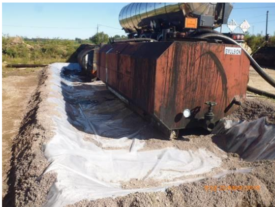
Ilustración 14 - Obrador: Tanques de emulsión asfáltica
