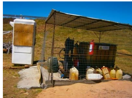
Ilustración 9 - depósito de combustible P01
