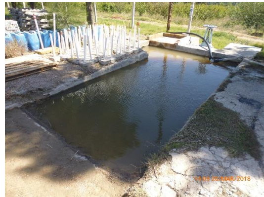
Ilustración 9 – Pileta de contención de aguas tratadas
