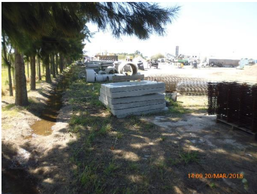
Ilustración 8 – Depósitos y canal colector de pluviales
