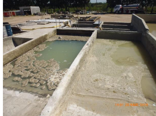
Ilustración 7 – Piletas de decantación/retención
