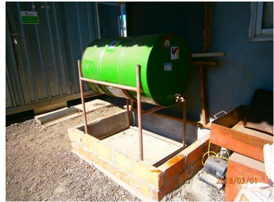
Ilustración 12 - tanque con producto químico con barrera de contención perimetral
