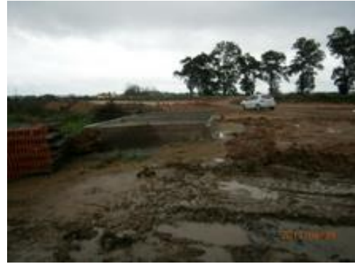
Ilustración 6 – Piletas de lavado de hormigones
