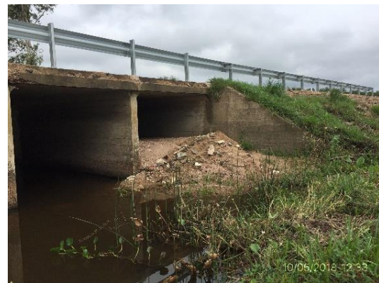
Ilustración 9 – Tramo de obra, alcantarilla sobre Ruta 13 progresiva 204K000 parcialmente obstruida.
