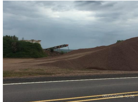
Ilustración 5 – Acopio de áridos en faja pública de Ruta 8 progresiva 366K500, lindero a obrador.
