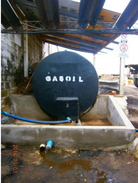
Ilustración 6 - Tanque de combustible en el obrador
