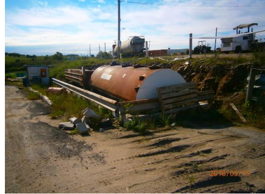
Ilustración 6 - Depósito de combustible.
