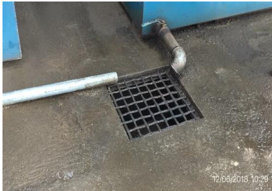
Ilustración 6 - Obrador. Trampa de combustibles.
