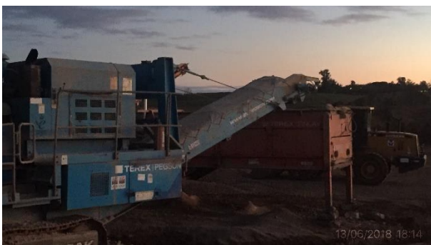
Ilustración 8 - Cantera: planta de trituración.
