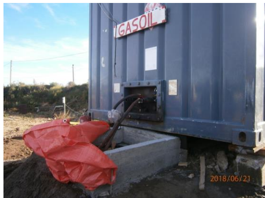
Ilustración 6 - depósito de combustible.
