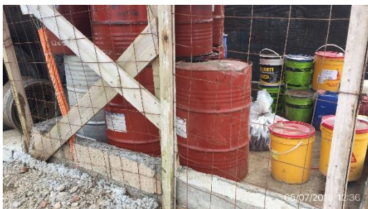
Ilustración 12 – Obrador, acopio de lubricantes usados
