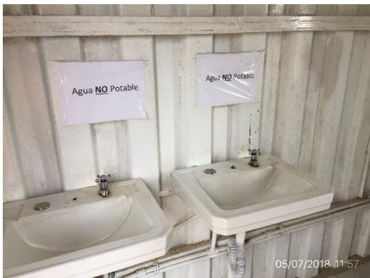
Ilustración 6 - Obrador. Baños con agua de pozo.
