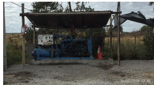
Ilustración 11 – Obrador, grupo electrógeno con piso y envallado
