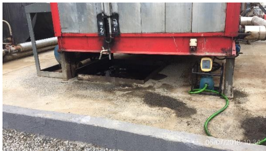
Ilustración 8 - Obrador. Equipo generador con envallado.
