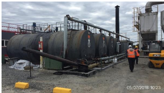
Ilustración 6 – Planta asfáltica con envallados perimetrales.
