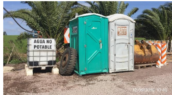
Ilustración 9 – P03 Obrador – Tanque de agua no potable
