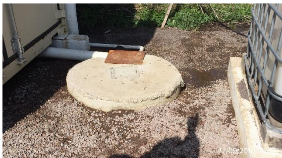
Ilustración 10 – P03 Obrador – Pozo negro
