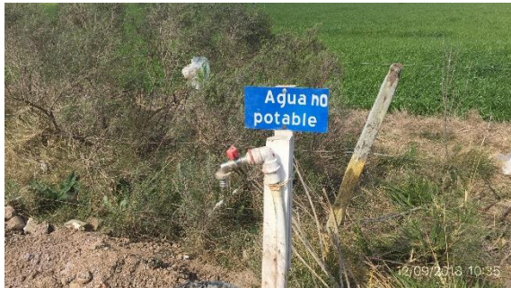
Ilustración 6 – P03 Obrador – Canilla de agua no potable desde tanque
