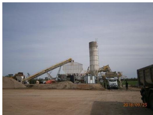
Ilustración 5 - planta de hormigón.
