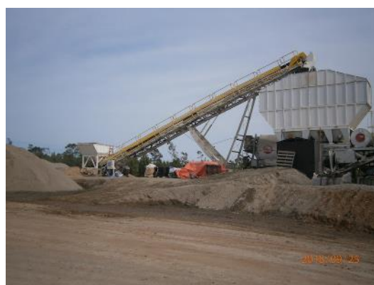
Ilustración 9 - planta de hormigón.
