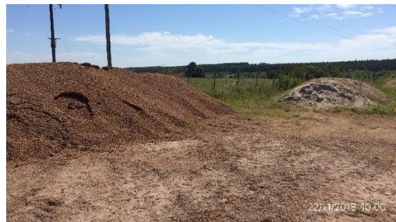
Ilustración 9 – Campamento provisorio, acopio de materiales. No hay canales de residuos segregados.
