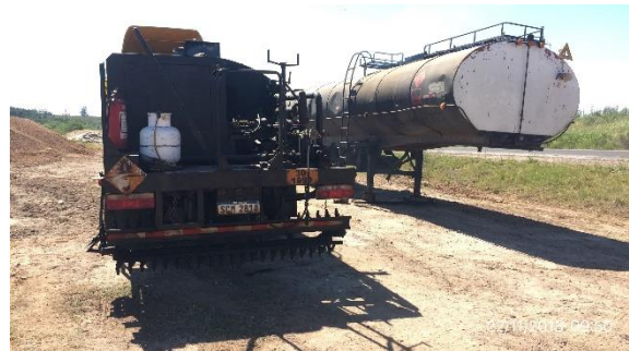
Ilustración 7 – Campamento provisorio – cisterna de emulsiones: no hay sistema de retención de derrames.
