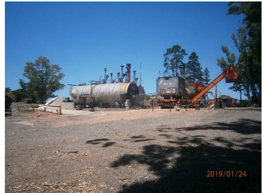
Ilustración 8 - Planta de Asfalto
