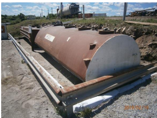
Ilustración 8 - Tanques de acopio de combustible con muro de contención y piso compactado impermeable
