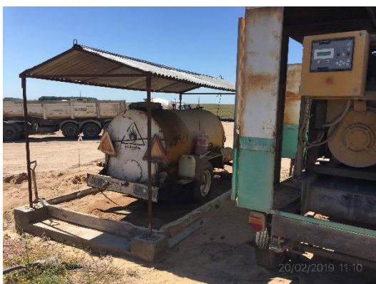
Ilustración 8 – Obrador. Generador con tanque de combustible envallado.
