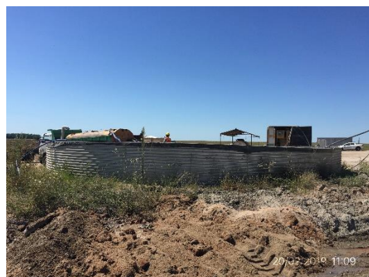
Ilustración 9 – Obrador. Tanque australiano para agua no potable, bombeada desde tajamar existente
