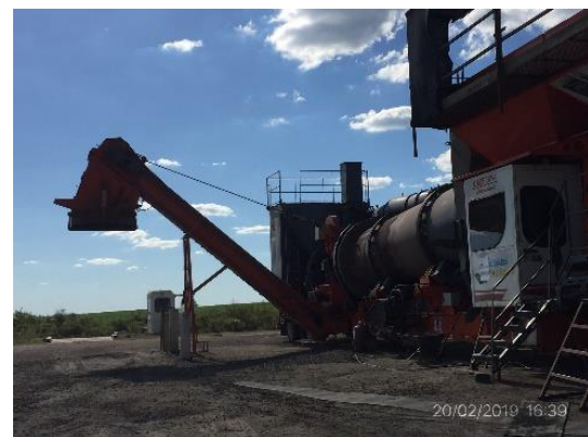
Ilustración 15 – Obrador. Planta de asfalto con filtro de mangas.
