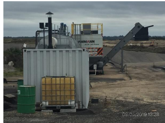
Ilustración 6 – Obrador: planta de asfalto sin actividad.
