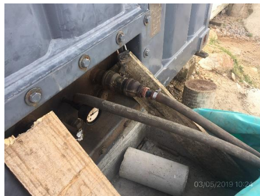
Ilustración 11 – Obrador – Pileta de contención en surtidor de tanque de Gas Oil
