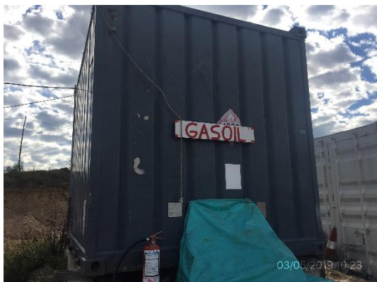
Ilustración 10 – Obrador – Tanque de Gas Oil con doble pared
