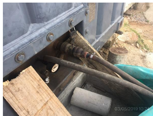
Ilustración 9 – Obrero – Pileta de contención en surtidor de tanque de gasoil
