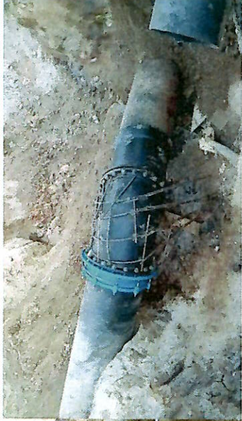
Imagen 12 y 13 – Empalme norte de la tubería
